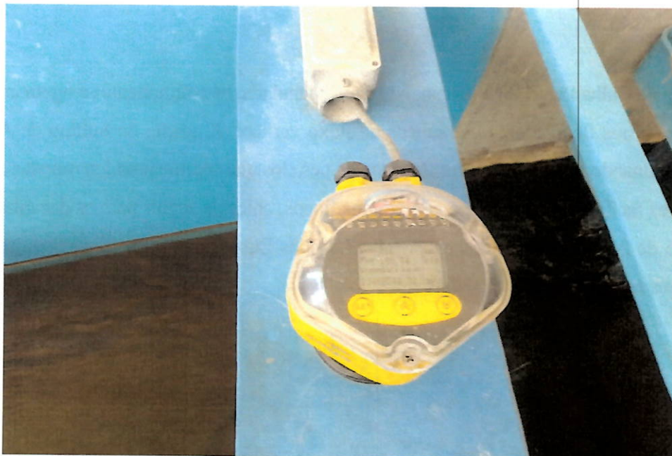
Foto 04 – Medidor de Vazão Ultrassônico (Calha Parshall).
