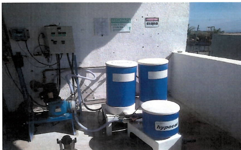
Foto 16 - Bomba Dosadora de Hipoclorito de Cálcio.
