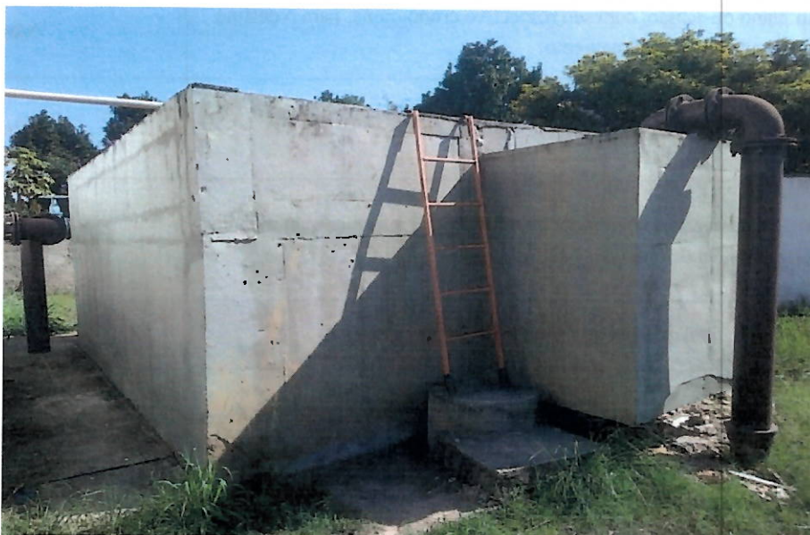
Foto 23 - Tanque de Homogeneizado de Lodo 9000 litros.
