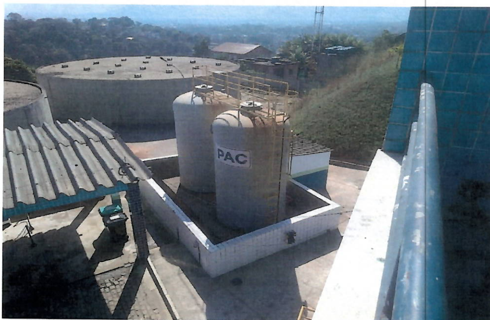
Foto 05 – Reservatórios Sulfato de Alumínio com 20 m³ de capacidade cada um.
