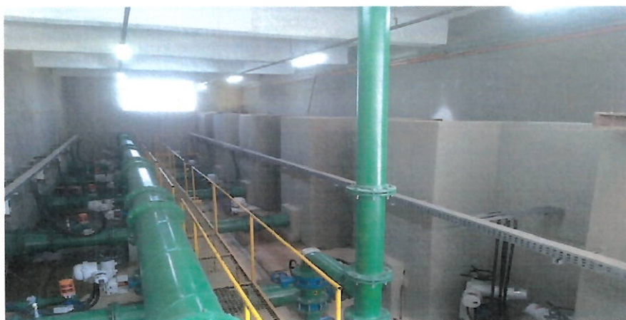
Foto 12 - Tubulações de Válvulas dos Filtros e Retrolavagem.
