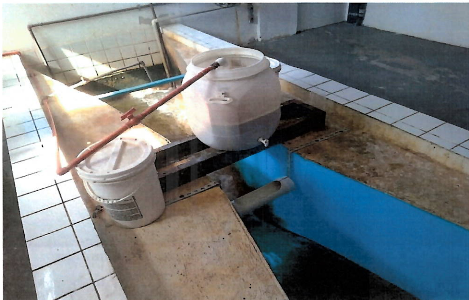
Foto 03 - Entrada da Água Bruta na ETA (Calha Parshall), aplicação do coagulante.
