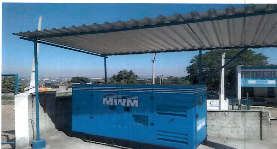
Foto 18 - Grupo Gerador da ETA.
