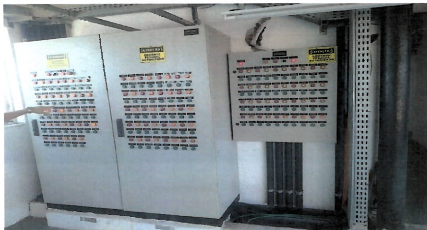
Foto 11 - Painéis de Comando das Comportas Decantadores e Filtros.
